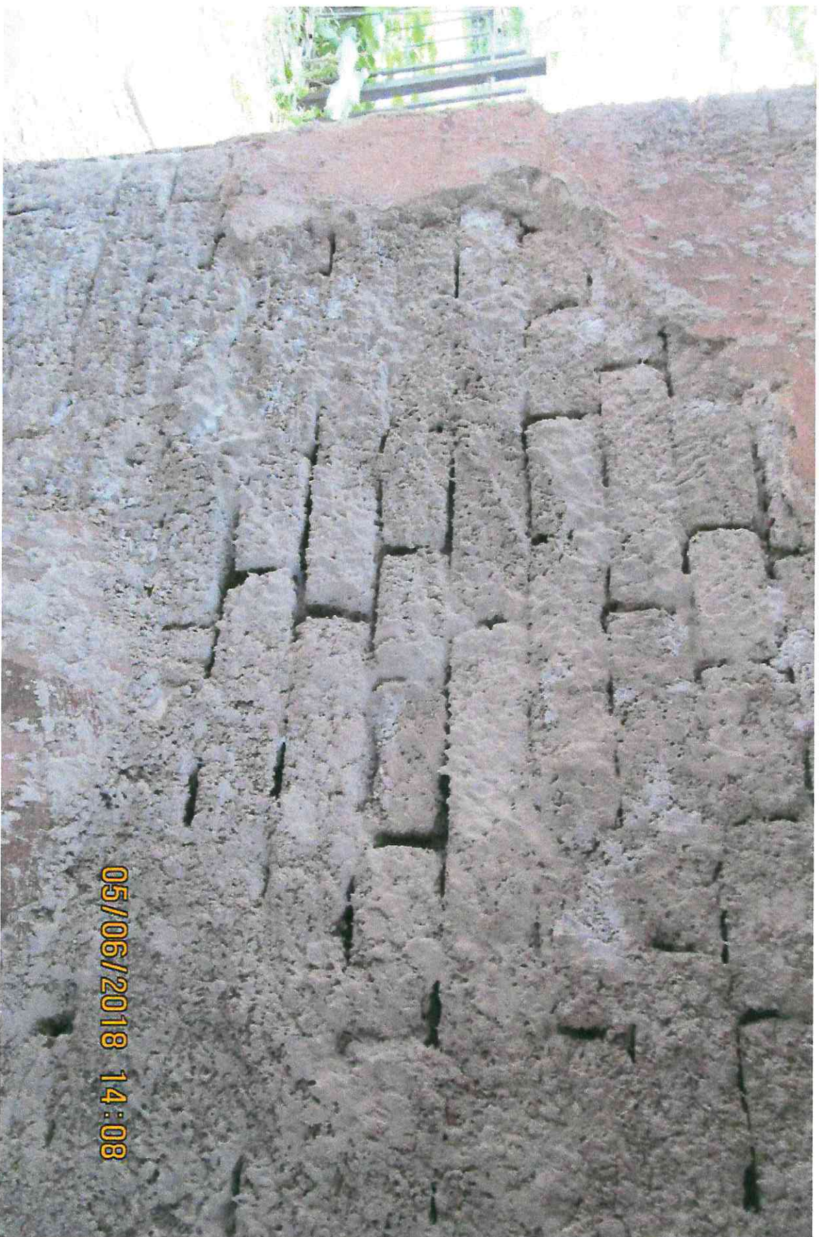
Иллюстрация №5 Необходимость производства работ по заделке кладочных швов до нанесения обрызга обусловлена недопустимостью формирования воздушных полостей между кладкой и штукатуркой
