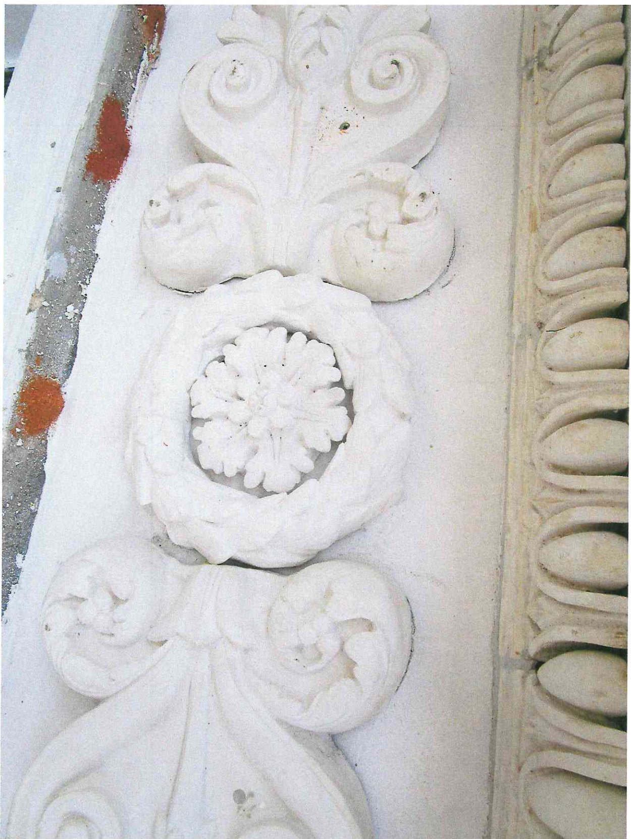
Фото №19 Замена лепнины, необратимо испорченной шпатлеванием
