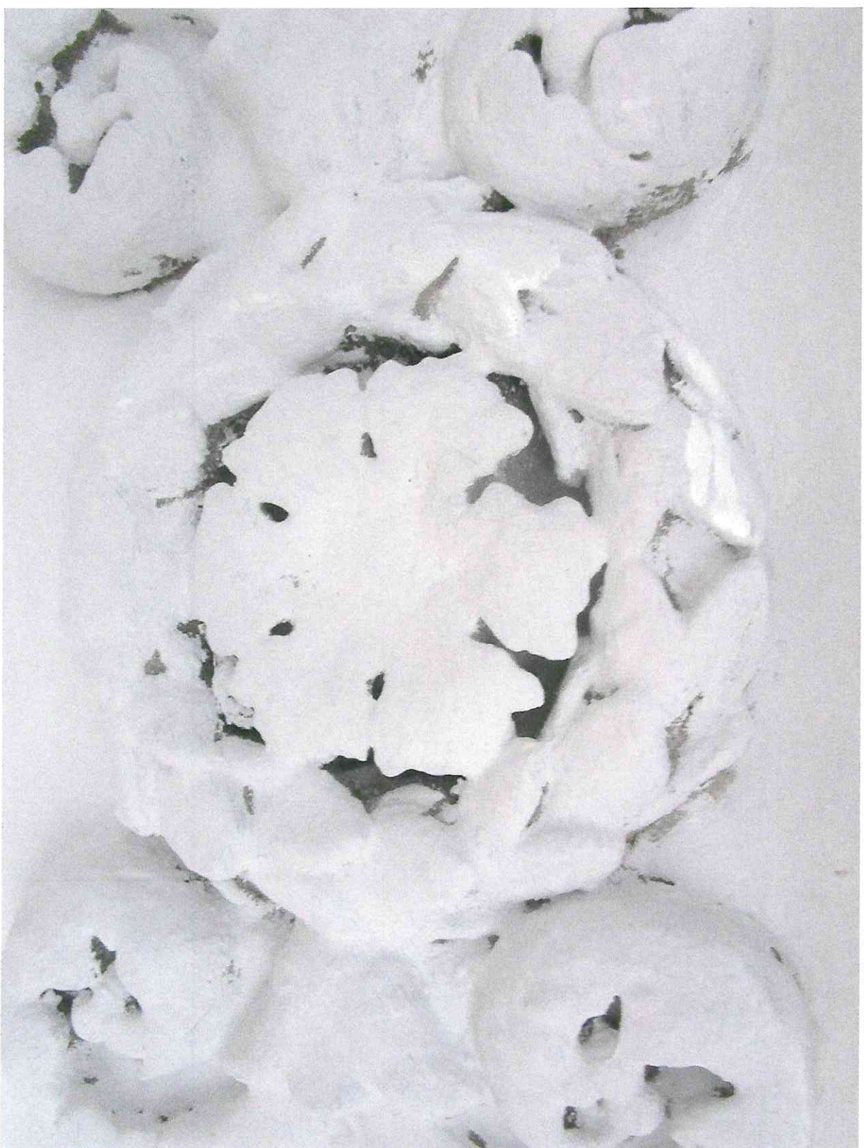
Фото №18 Обмазанная шпатлевками или гипсом лепнина подлежит замене
