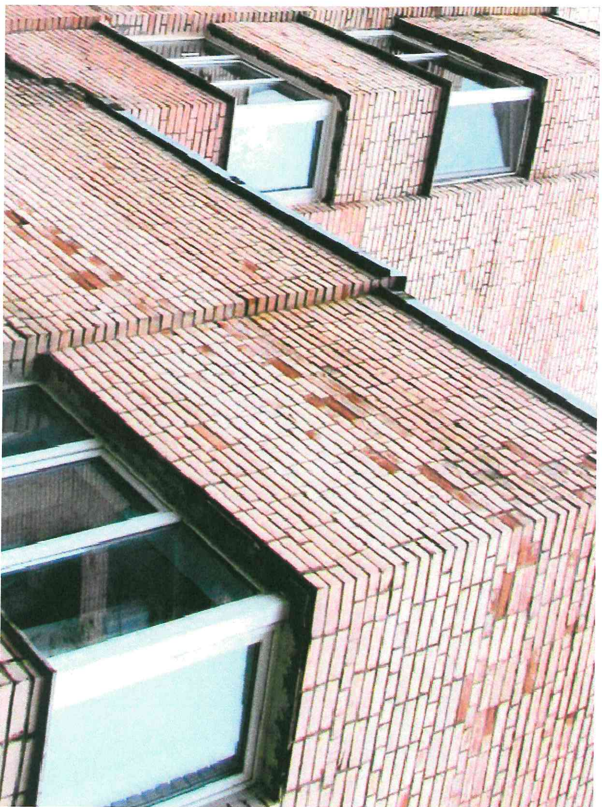
Деструкция уплотненного поверхностного слоя лицевого кирпича с раскрытием красного керамического объема
