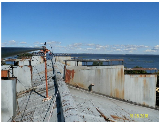
ДО КАПРЕМОНТА Комсомола ул., д.1/16
